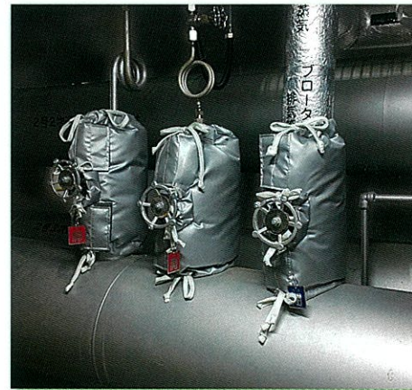
ボイラー周辺バルブカバー
